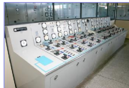
Sala de comando
