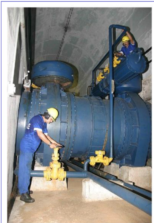
GALERIA DE VÁLVULAS
