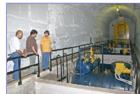
Galeria de válvulas
