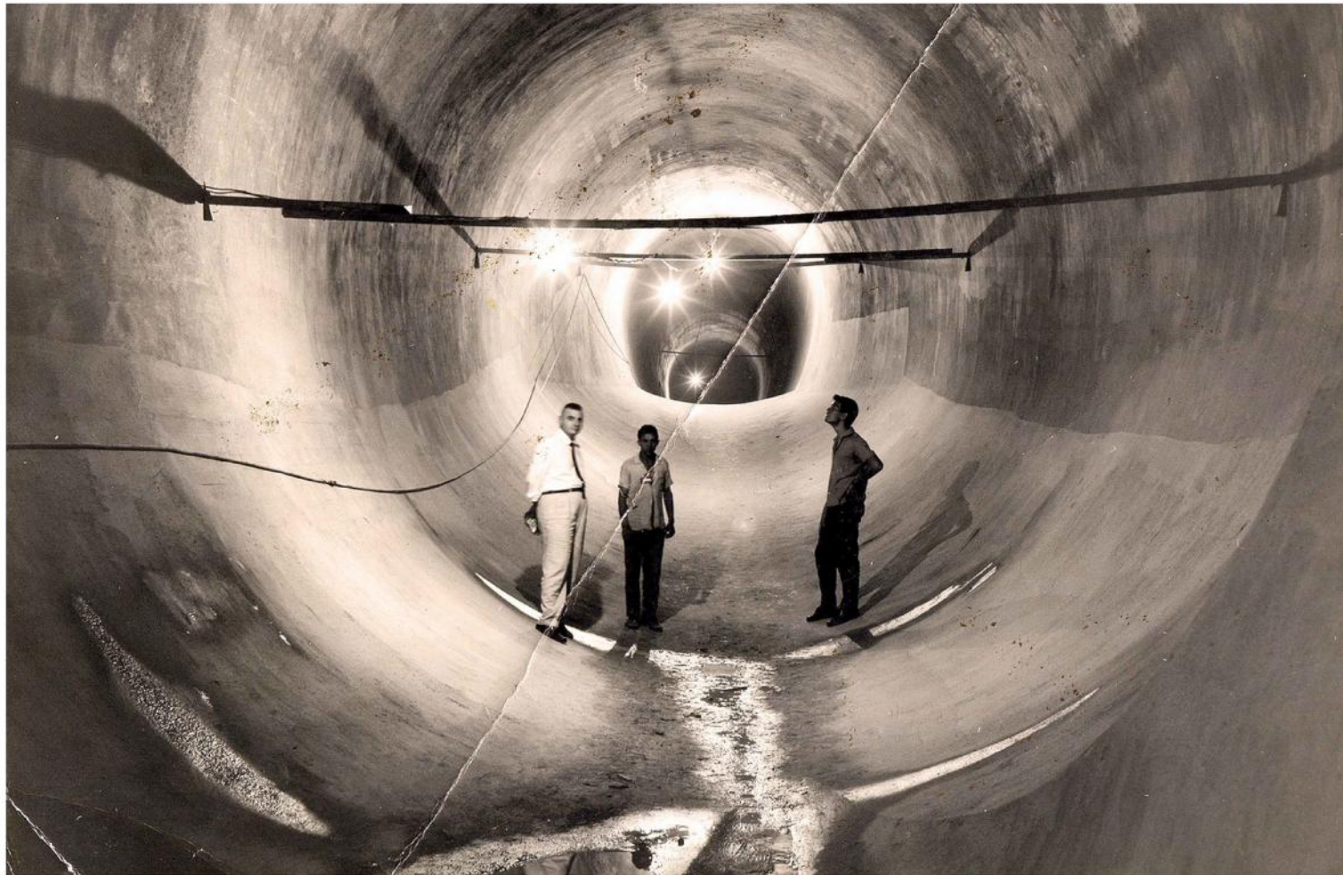
SUCÇÃO DA ELEVATÓRIA DO LAMEIRÃO - TÚNEL
